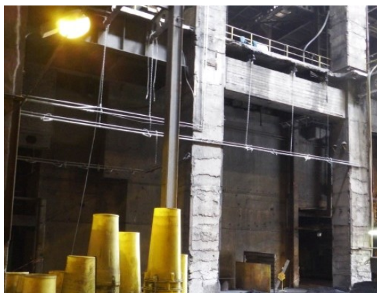
Rys. 9. Zabudowa instalacji zraszającej na stanowisku rozładunku węgla oraz załadunku węgla do kubłów [5]
