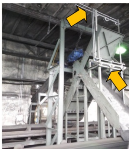
Rys. 11. Zabudowa instalacji zraszania na przesypie z przenośnika zgrzeblowego na taśmowy [5]
