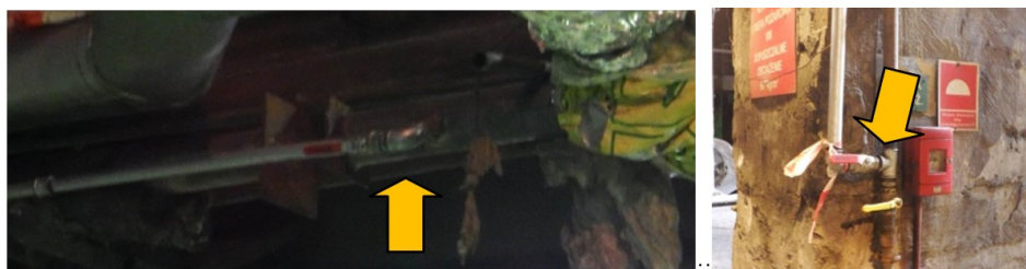
Rys. 7. Przyłącze magistrali: a) rozprowadzającej wodę do istniejącej infrastruktury na poziomie „+32,0m”; b) rozprowadzającej sprężone powietrze zabudowane do istniejącej infrastruktury na poziomie 0,0m [5]
