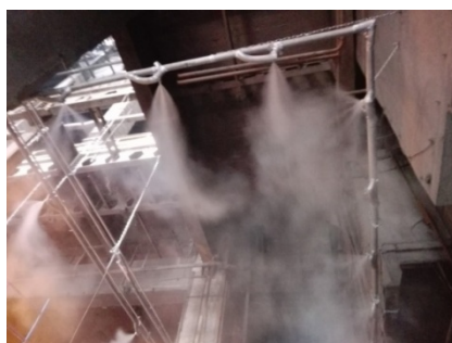
Rys. 12. Instalacja zraszająca zabudowana na stanowisku rozładunku węgla [5]
