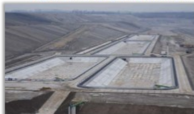
5 zbiorników retencyjno-osadowych i laguna w ramach systemu odwadniania odkrywki w PGE GiEK S.A. Oddział KWB Turów
