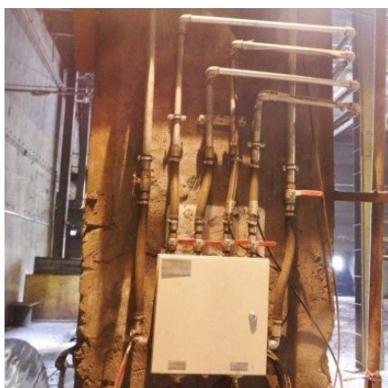
Rys. 8. Przykładowe podłączenie magistrali do skrzyni zasilająco-sterującej, zlokalizowanej na poziomie 0,0m [5]
